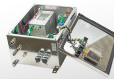
Industriecomputer im Schaltschrank
